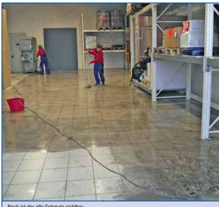
Noch ist der alte Schmutz sichtbar.
